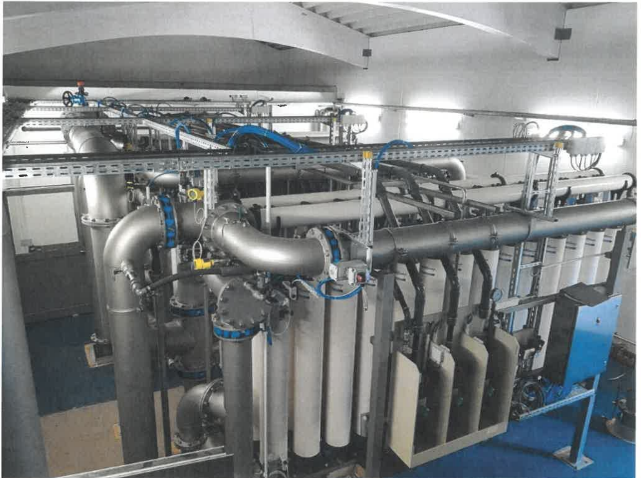
Abb. 22: Ultrafiltrationsstraße WA Hohemark
